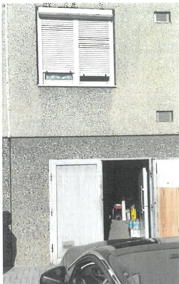
2. ábra Érintett falszakasz, és a felette lévő homlokzati panel
